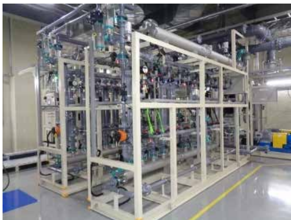
NCDK富士吉田工場の再生水処理装置
