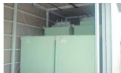
PCB使用機器保管庫（知多事業所）
