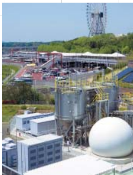
「愛・地球博」の新エネルギーシステムに組み込まれたNAS ® 電池(左下)
