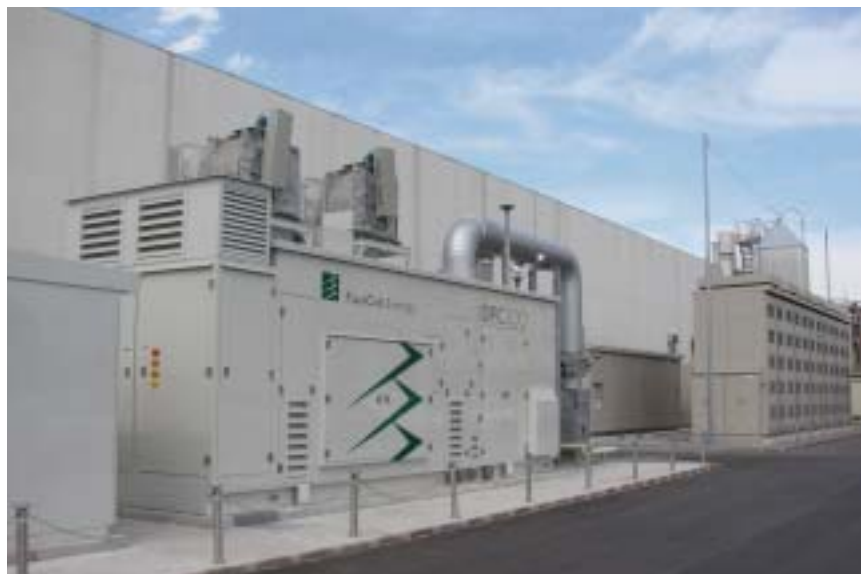
燃料電池（手前）とNAS®電池（奥）併用システム
