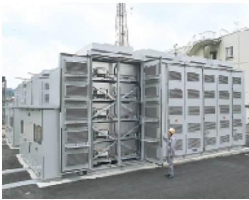
NAS®電池(ナトリウム硫黄電池)電力貯蔵システム
