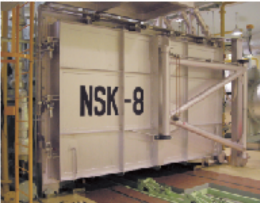
蓄熱して燃焼効率を上げるリジェネバーナーを使用している NSK-8
