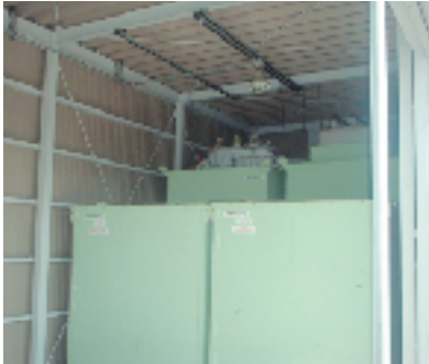
PCB使用機器保管庫(知多事業所)
