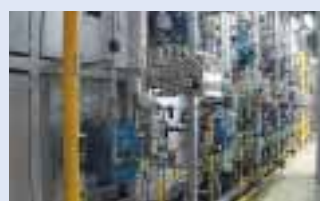
炉体両面上下に設置されたリジエネバーナー
