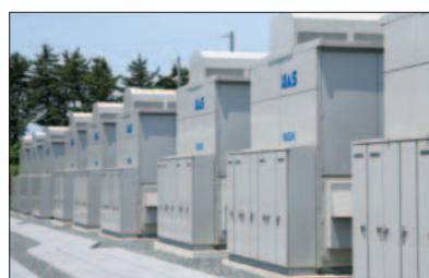
電力貯蔵用NAS電池
