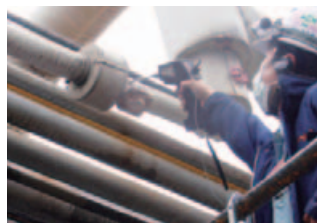
蒸気漏れ診断(日本ガイシで実施)
