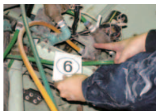
エア漏れ診断(日本ガイシで実施)
