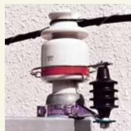
配電用がいしと耐雷ホーン
