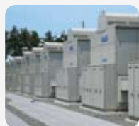
電力貯蔵用NAS電池
