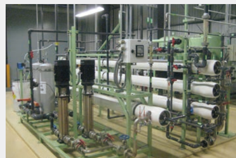
逆浸透膜を用いたろ過装置
