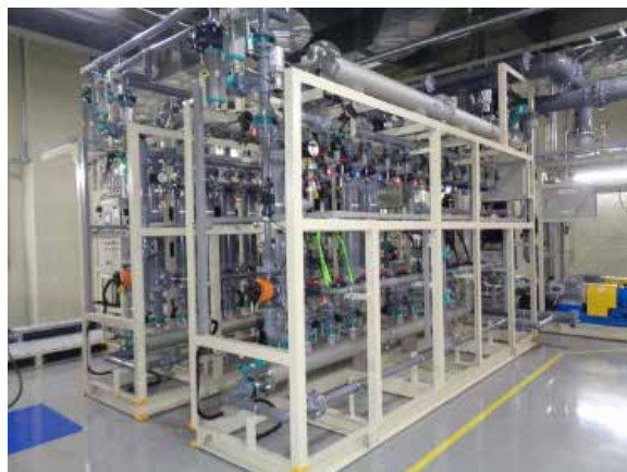
再生水処理装置（NCDK富士吉田工場）
