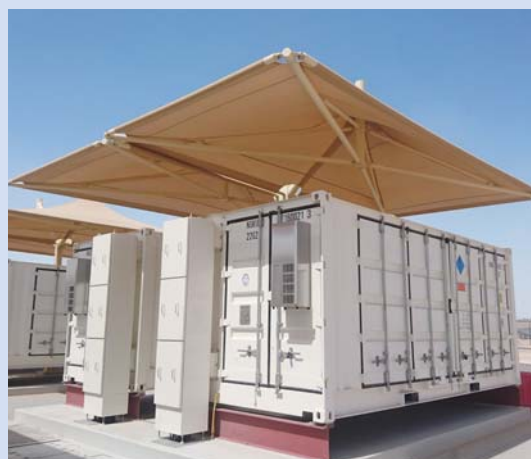
ドバイに設置されたNAS電池
