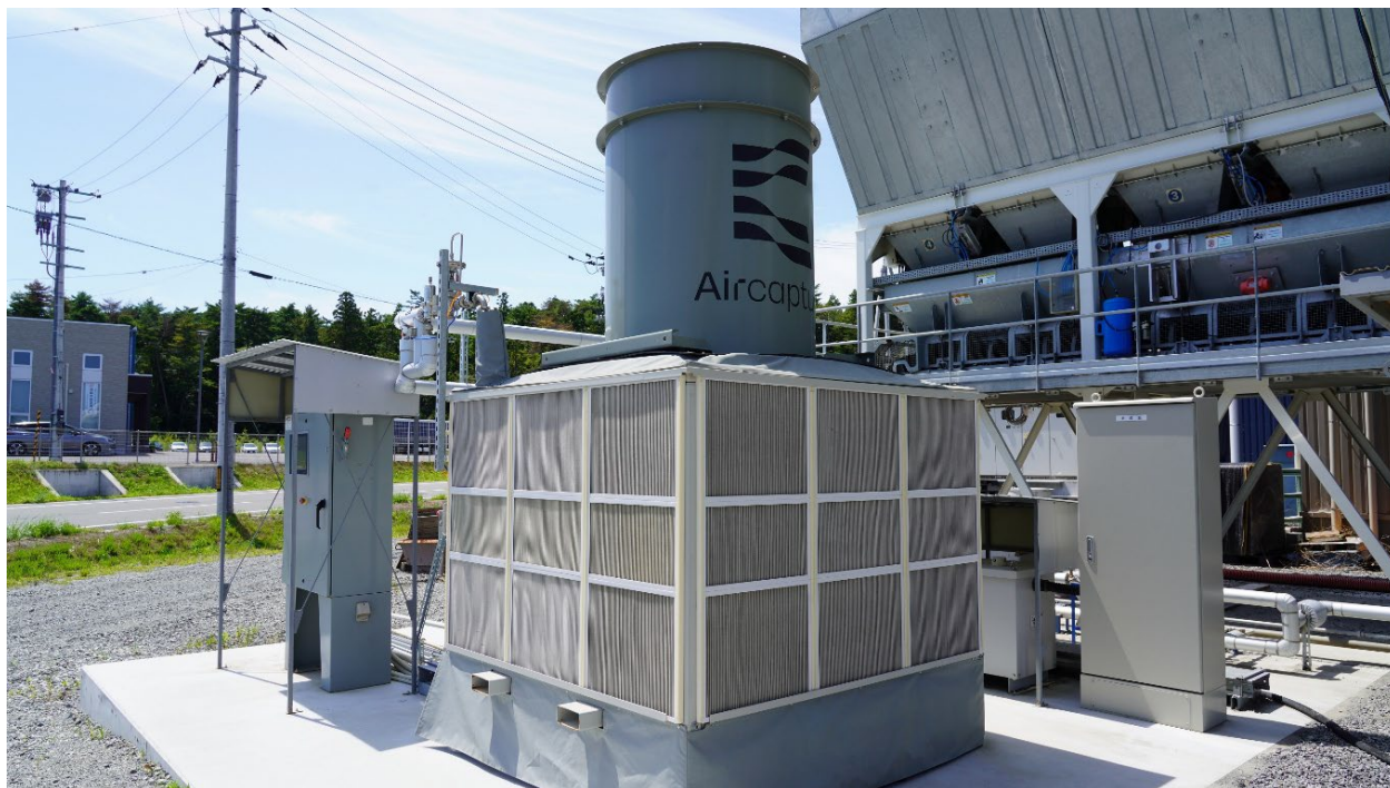
福島 RDM センターに設置された DAC 実証設備
