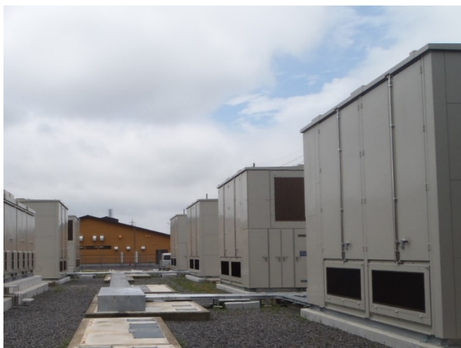
運転を開始したNAS電池
