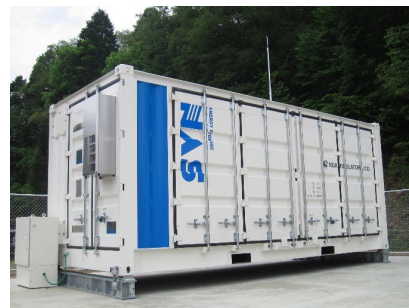
吉田発電所内に設置された 恵那電力のNAS電池
