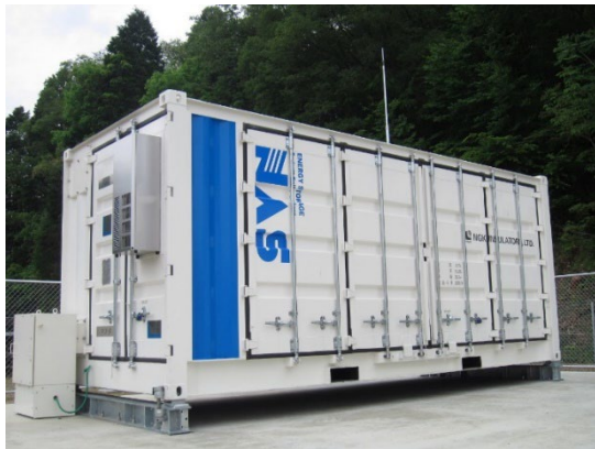
恵那市内に設置された恵那電力のNAS電池
