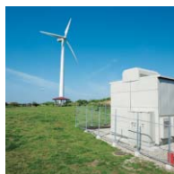
電力貯蔵用NAS®電池
