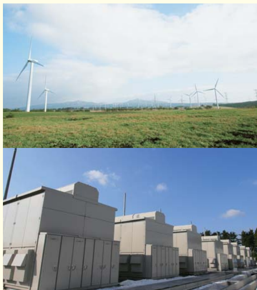
NAS®電池が併設された六ヶ所村の風力発電所
